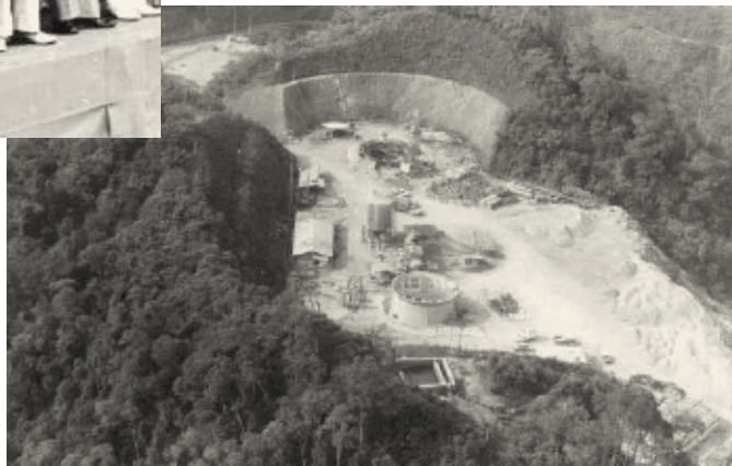
Central Hidroeléctrica de San Carlos, en Antioquia.
